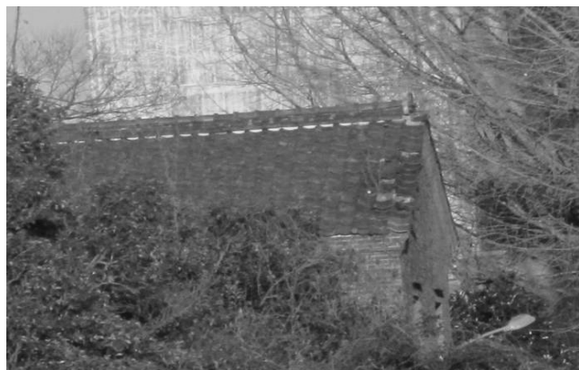
江戸川対岸よりみた「赤レンガ武器庫」右端の 1 列・2 列目に瓦のずれが大きく判る。2 列目・3 列目の中段部に実生の木が育っているのが見える。（2014/01/16 撮影）
