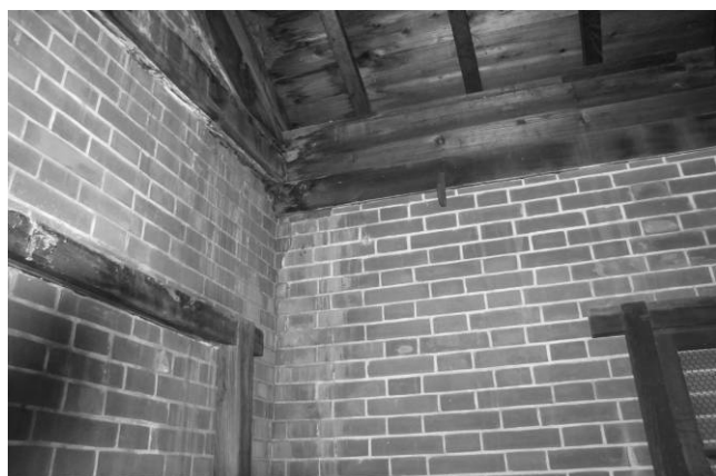
上の写真の内部 敷桁、垂木、野地板など構造部に腐朽が進行している。煉瓦壁面にはカビが生えている。
